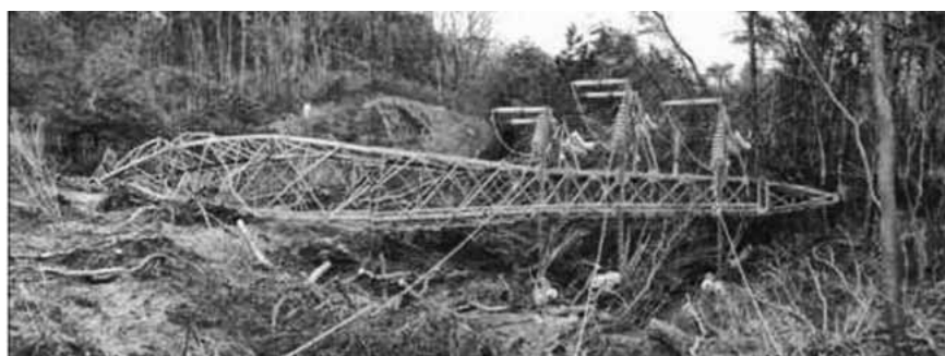
Figura 6, La distruzione della rete elettrica.
