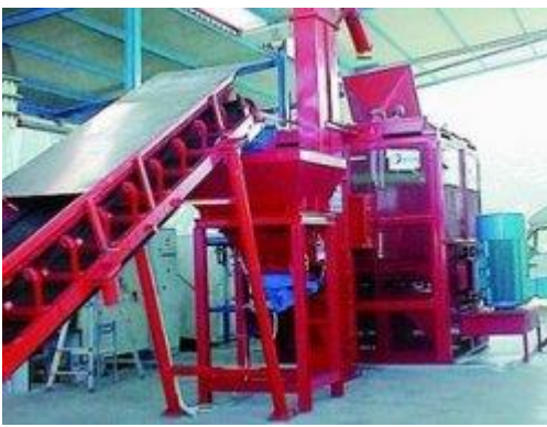
Thor impianto rifiuti. Fonte Internet
